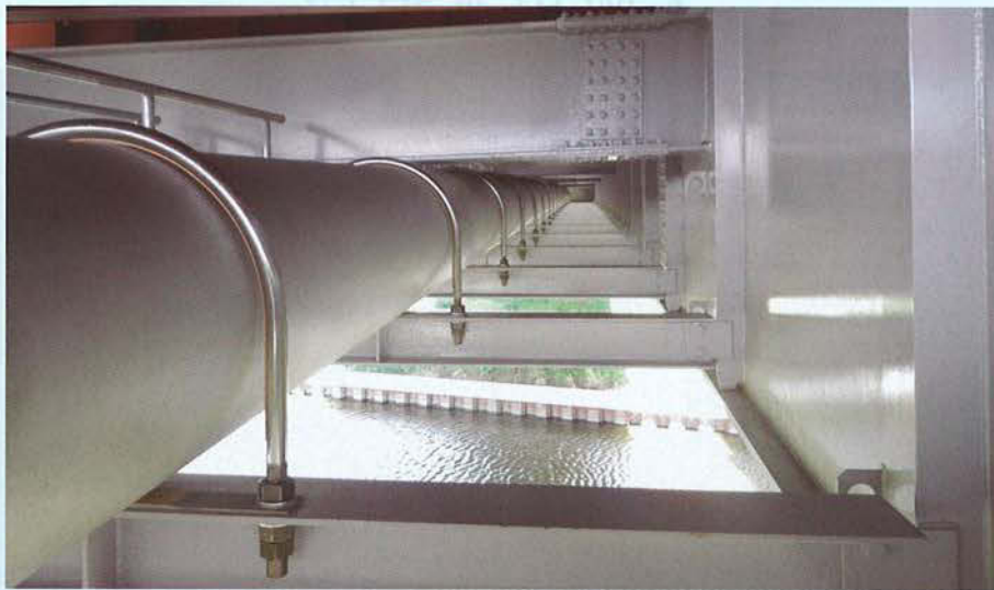
道路橋添架状況(φ600mmステンレス鋼管)
