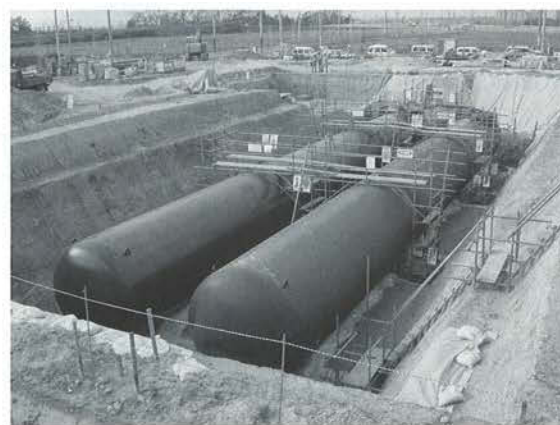
大容量貯水槽の設置例
