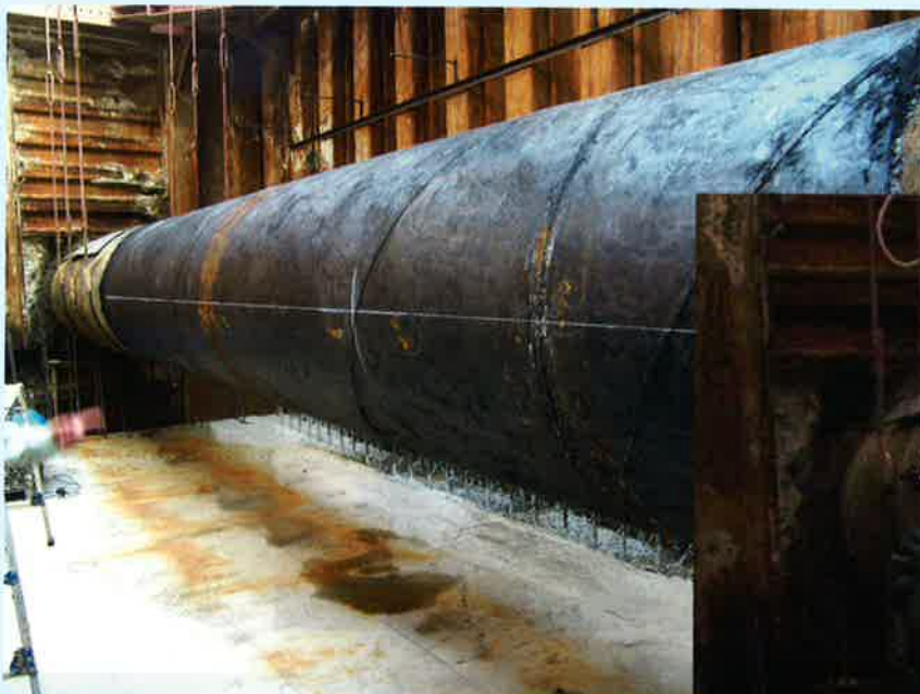
老朽した既設管
