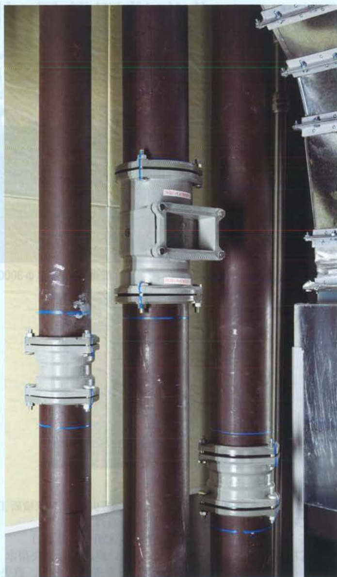
排水・通気管に用いられたDV-A
