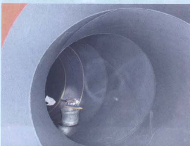
推進部 内面塗装状況
