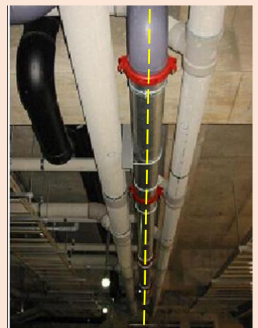
直線的な配管
